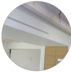
PLENUM HIDDEN DIFFUSER
